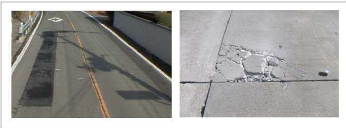
(占用復旧跡の沈下) (コンクリート舗装の角欠け)
